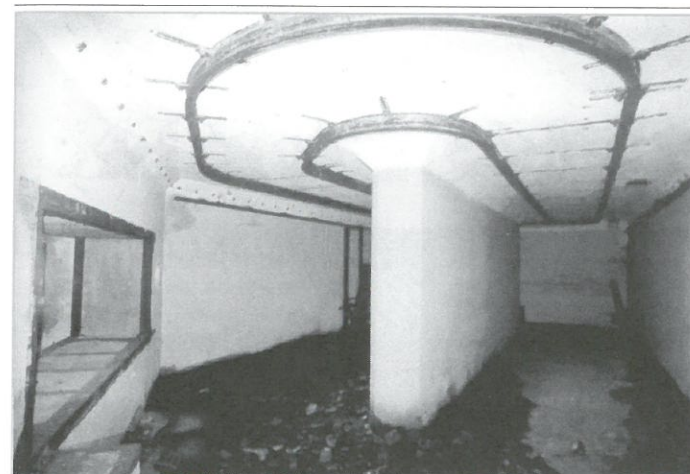
Wnętrze komory ładunków prochowych z zachowanymi szynami kolejki podwieszanej i wózkiem do składania ładunków.
